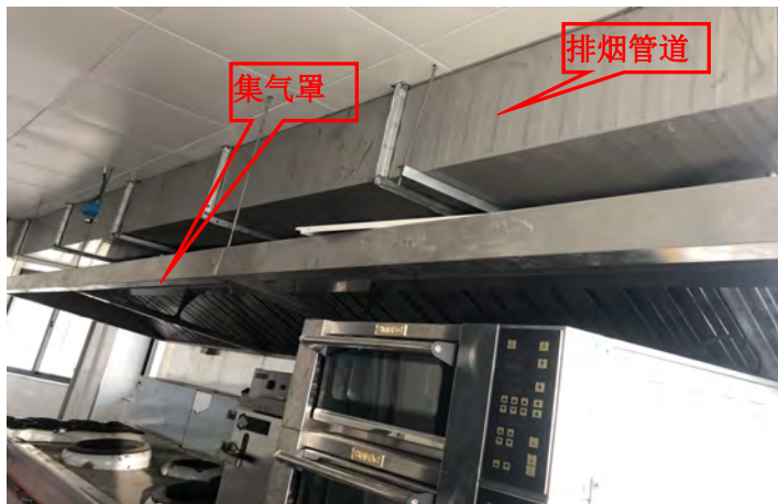
厨房集气罩照片
